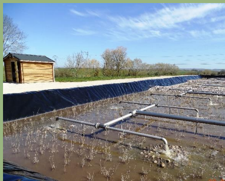
Mise en service de la STEP
